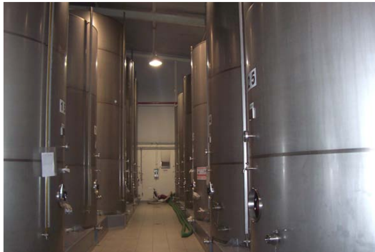
Fotografía N° 7. Tanques de acero inoxidable de la Fábrica Nucete.
