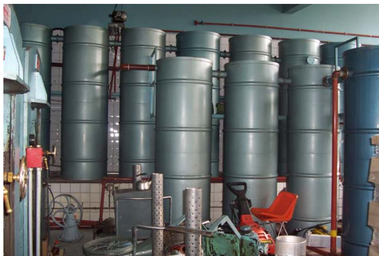
Fotografía N° 8. Depósitos de acero inoxidable de la Fábrica Panocchia.
